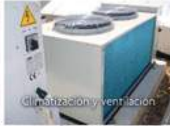
Refrigeración de bodegas
